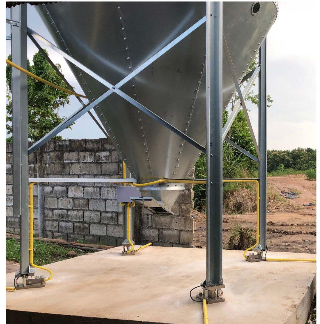
รูปที่ 1.18 ลักษณะการติดตั้งโหลดเซลล์แบบ Double End Shear Beam ที่ขาถังไซโล [16]
